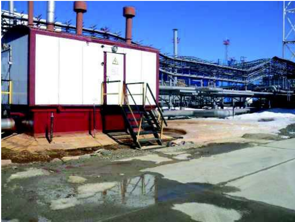
Рис. 4.3.8 След ржавого цвета от наледи вблизи насосной станции (май)
