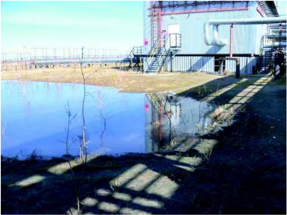
Рис. 4.3.9 Участок насыпи, подвергшийся избыточному обводнению
