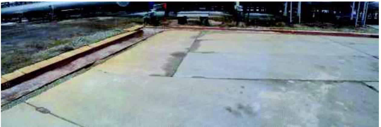
Рис. 4.3.7 След ржавого цвета от наледи вблизи водоотводных лотков (май)
